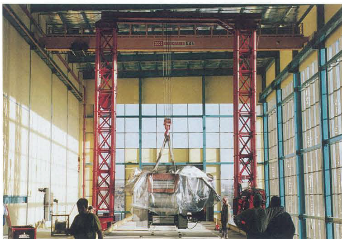
Das Setzen des ersten Druckwerkes mit dem SCHOLPP-Portalkran, der eigens dafür nach Saudi-Arabien per Schifftransport gebracht wurde.
