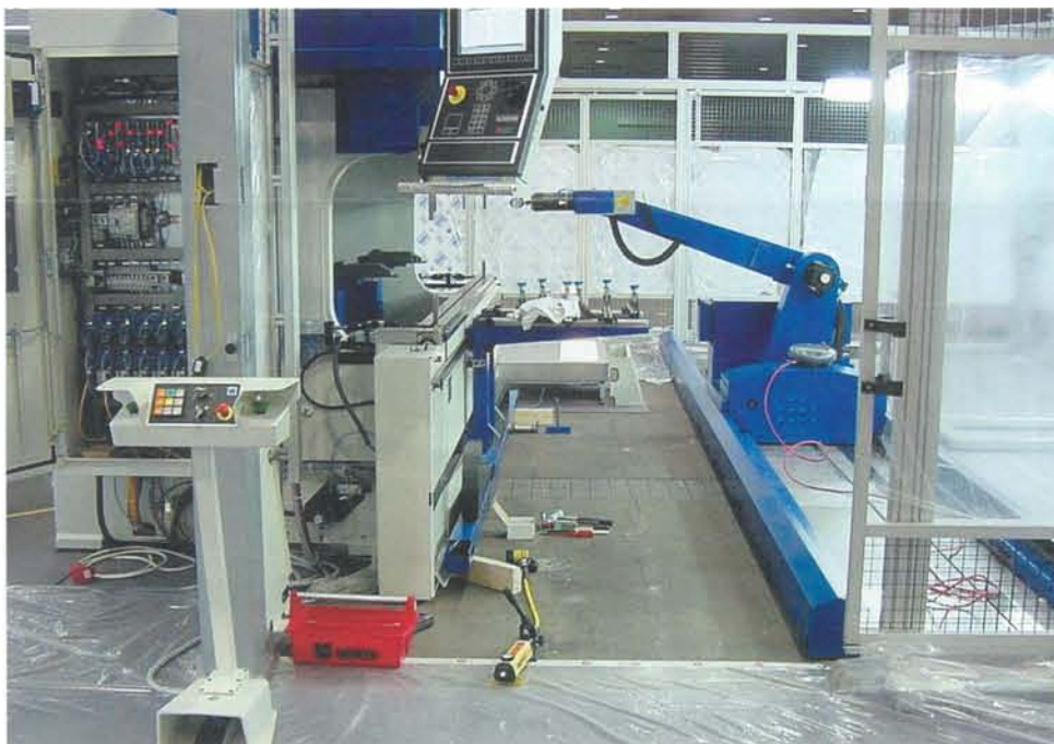
Montage einer Abkantmaschine Trumabend mit Bendmaster.
