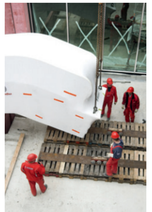
Die Fahrtreppe schwebt ins Einkaufszentrum
