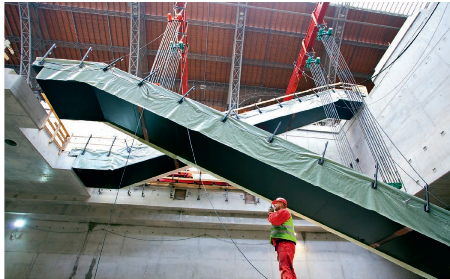
SCHOLPP sorgt für Bewegung im City-Tunnel Leipzig: Das Einheben von vier 15-Meter-Stahltreppenaufstiegen à 40 Tonnen erfolgt sicher mit Hubgerüsten.
