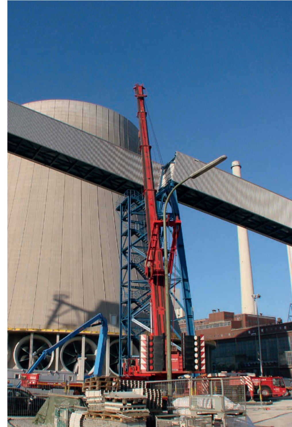
Einhub des vorletzten Kohlebandbrückenteils in luftiger Höhe mit einem S-GK 700 mit Superlift.
